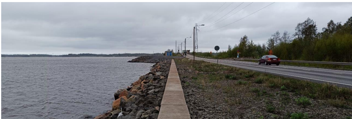
Kaava-aluetta idässä reunustava 20 kV voimajohto betonikanavineen.
